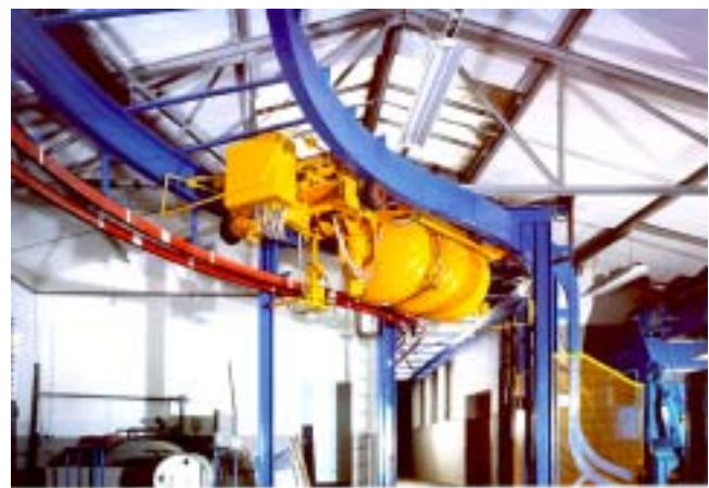
Voeding en besturing van een betonkubel
